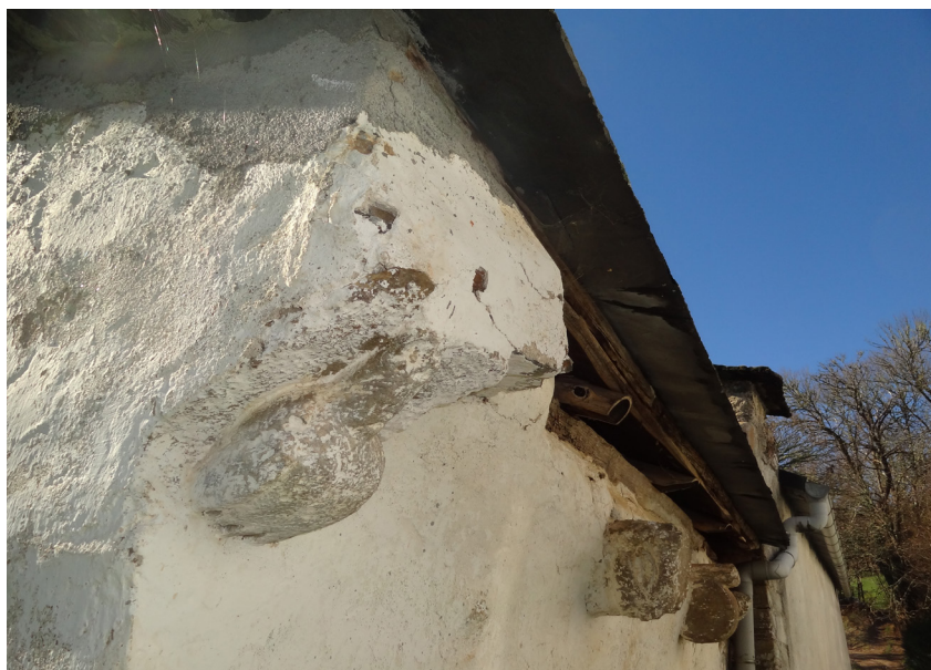
Figura 4. Liber. Muro setentrional da ábsida coas ménsulas 5-7. Obsérvase o recrecemento posterior do muro por riba dos canzorros (fotografía do autor).
